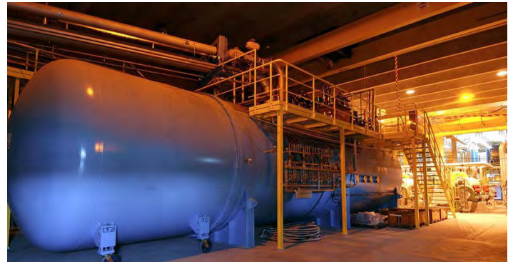
Un refrigerador de helio del LHC.
