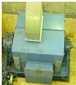
Fig. 12: Fotografía del generador
