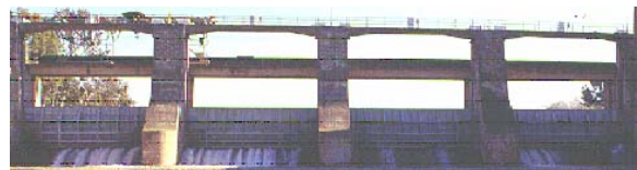
Figura 14: Compuertas de la central de Villafranca
