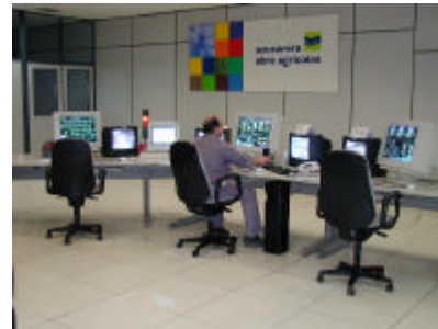
Fig. 2. Operario de planta en una sala de control
