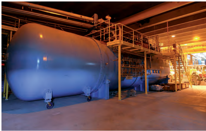
Una de las 8 cold-box de 18kW a 4.5K que se emplea en el LHC.
