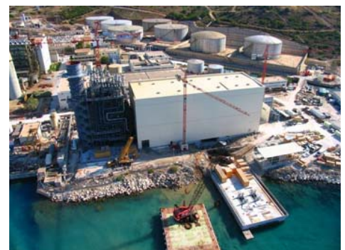
Ciclo Combinado Lavrion (Grecia) 109 FA-GE 400 MWe
